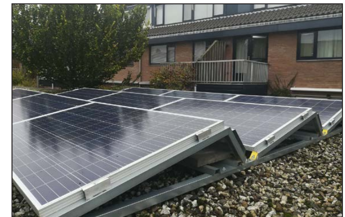
voorbeeld zonnepanelen op garagedaken
