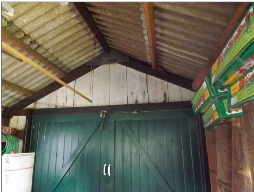
Het dak van het schuurtje bestaat uit een enkele laag van asbest golfplaten en er zijn geen tussenruimtes aanwezig waar vleermuizen gebruik van kunnen maken. Foto: R.C.H. van Marrewijk | Ecoresult B.V.
